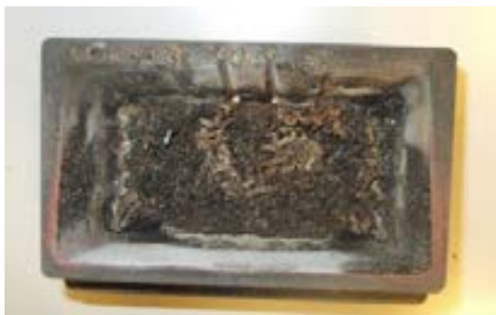
RUSZT KTÓRY WYMAGA CZYSZCZENIA
