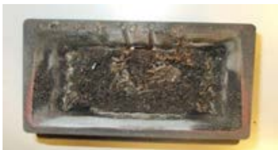
RUSZT KTÓRY WYMAGA CZYSZCZENIA
