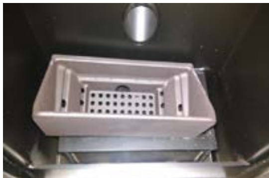
PRZYKŁAD NIEPOPRAWNEGO MONTAŻU
