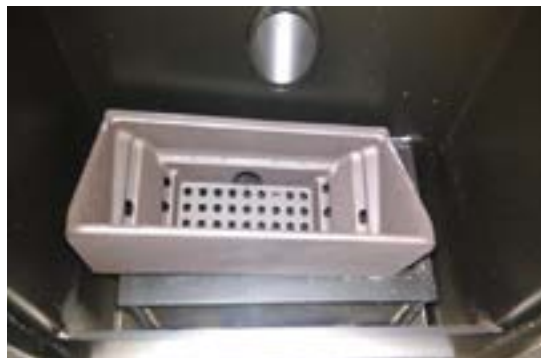
PRZYKŁAD NIEPOPRAWNEGO MONTAŻU
